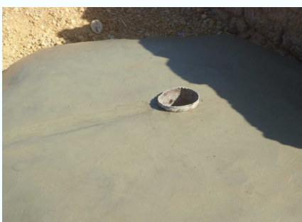
7. Si le ménage a un peu de moyen, une couche en ciment peut être faite au niveau de la clôture pour stabiliser d'avantage la latrine et empêcher l'infiltration.
