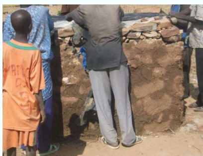
5. Une matière en plastique est utilisée pour couvrir le toit et diminuer l'infiltration.
