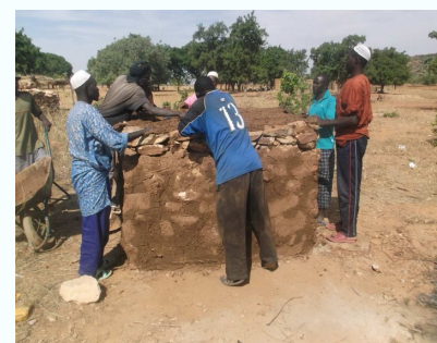
6. Le tout est couvert du mélange précédent (2) pour empêcher l'infiltration de l'eau par le toit.
